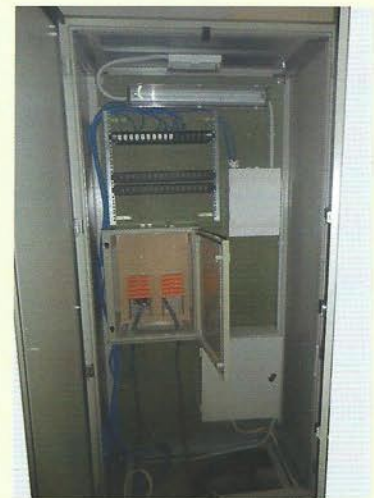
Figura 7.7. Registro principal de la red de cables de pares en el interior del RITI.
