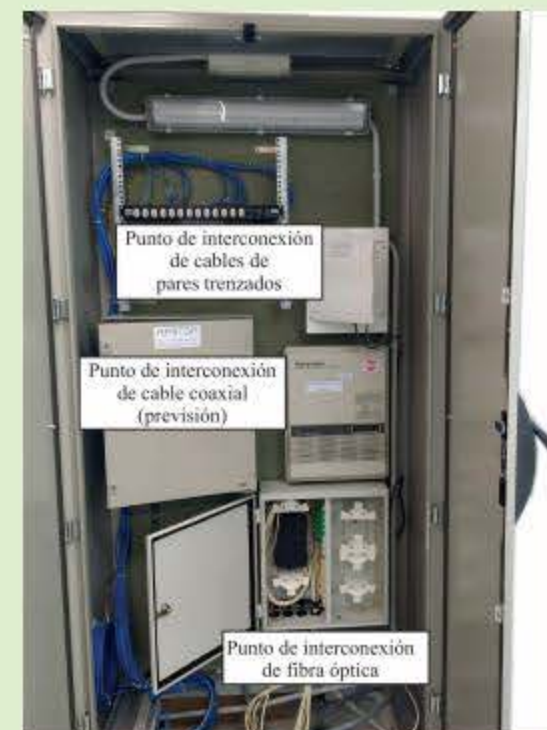
Figura 7.7. Registros principales en el interior del RITI.
