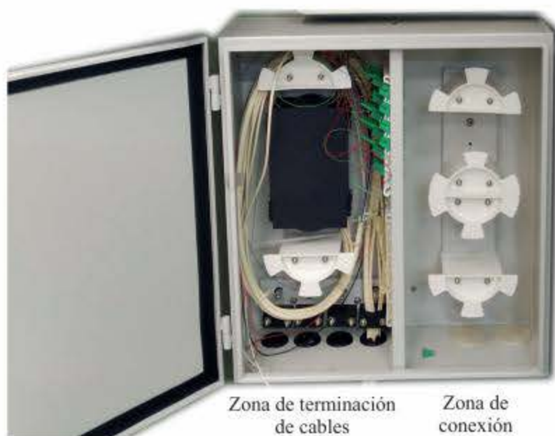
Figura 7.45. Punto de interconexión óptico.
