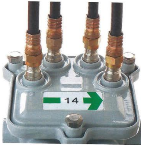
Figura 6.16. Distribuidor de cable coaxial.
