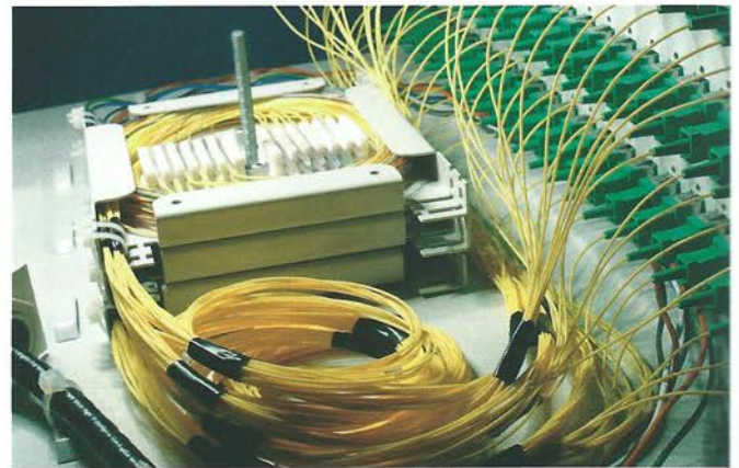
Figura 6.80. Panel de distribución que incluye bandejas de empalme.
