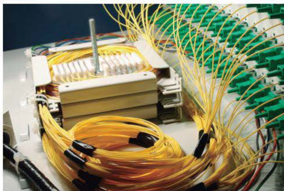
Figura 6.73. Panel de distribución que incluye bandejas de empalme.
